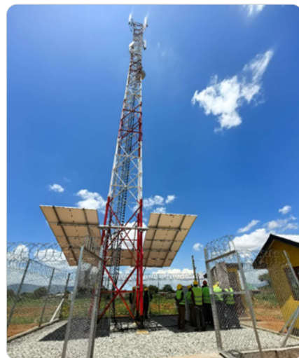
▲ 坦桑农网 - 已建成铁塔
