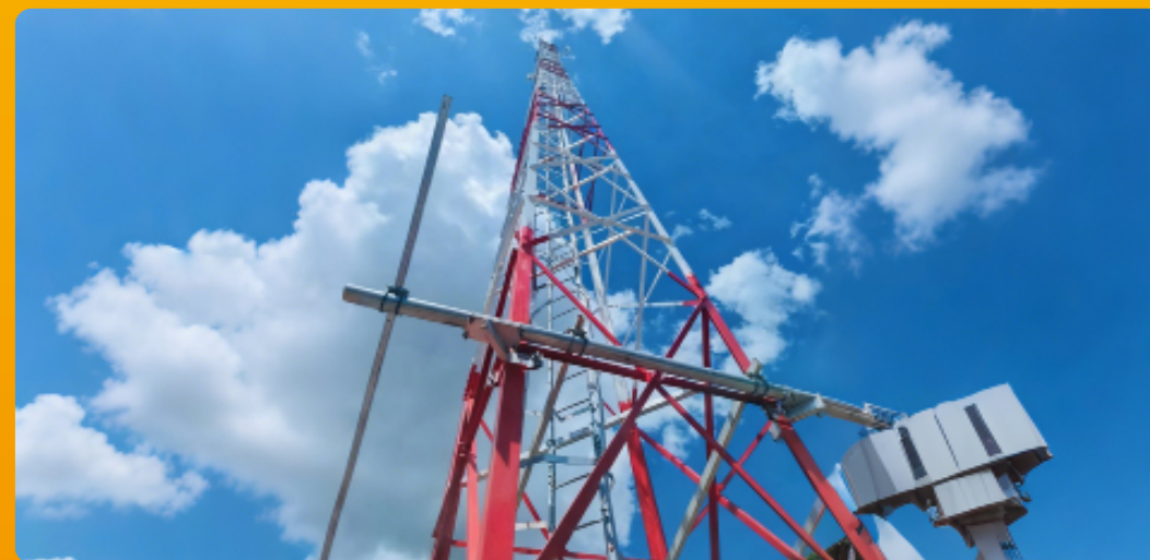
▲ 图为坦桑尼亚滨海区姆库兰加（Mkuranga）新落成的一座通信基站，它是 636 个基站建设项目中的一部分。随着基站的建成，当地超过 3 万人口首次接入稳定的移动通信网络，它的信号覆盖让过去常年“无信号”的村庄第一次能够打电话、上网。
